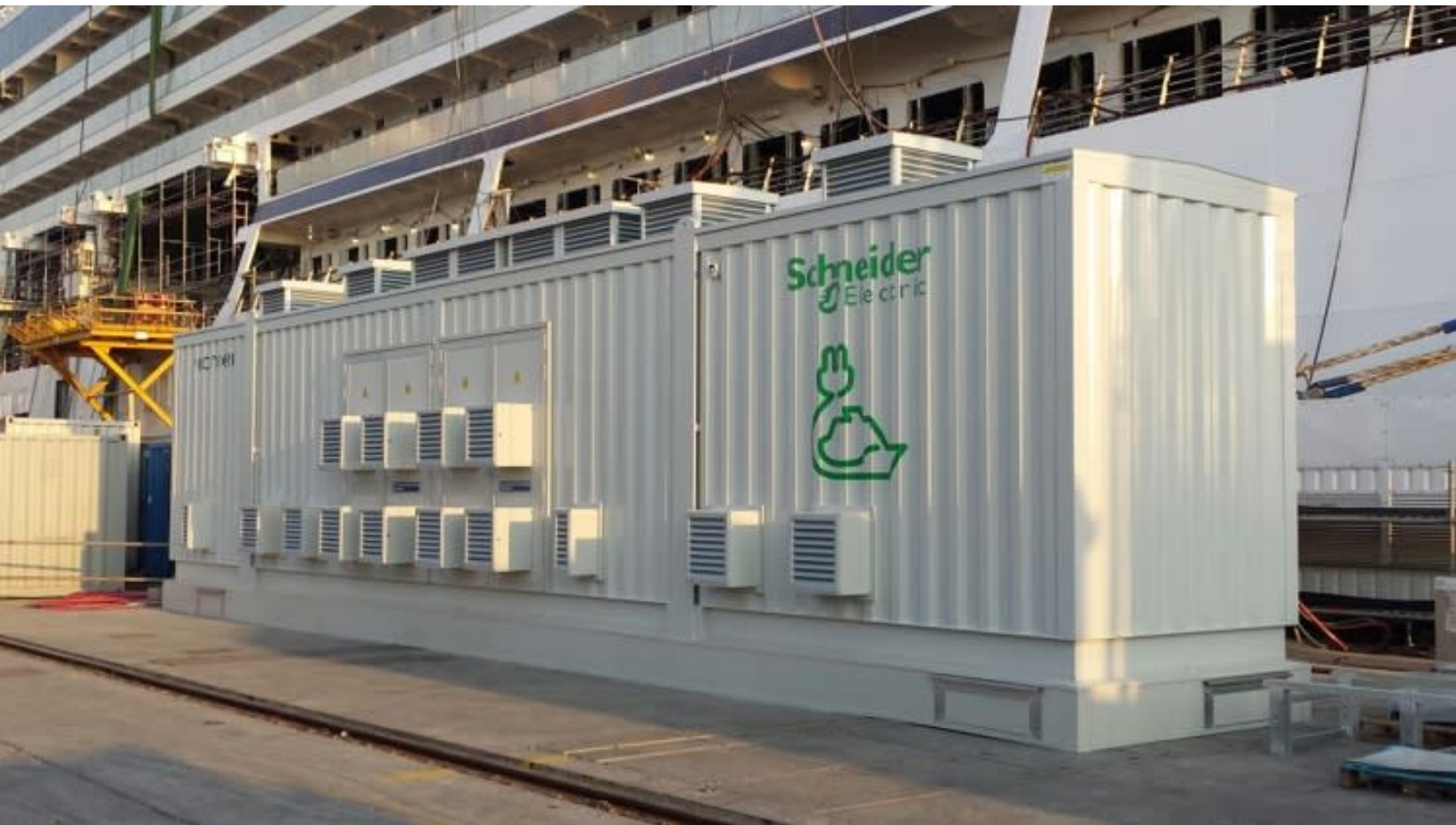
Schneider Electric landstrømsanlæg til Korsør Havn
